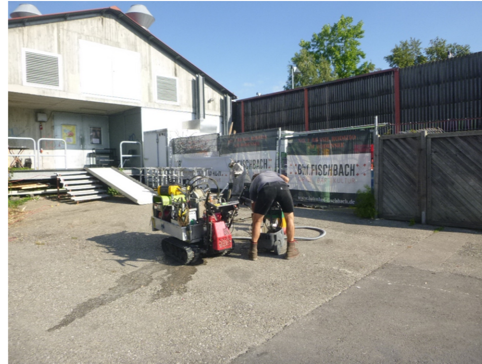
Bild 2: Blick nach Norden auf den Bohransatzpunkt BS 1. Die Wasserspülung der Kernbohrung in der Schwarzdecke wird gegen Schadstoff-Verschleppung in die unterlagernden Bodenhorizonte abgesaugt.
