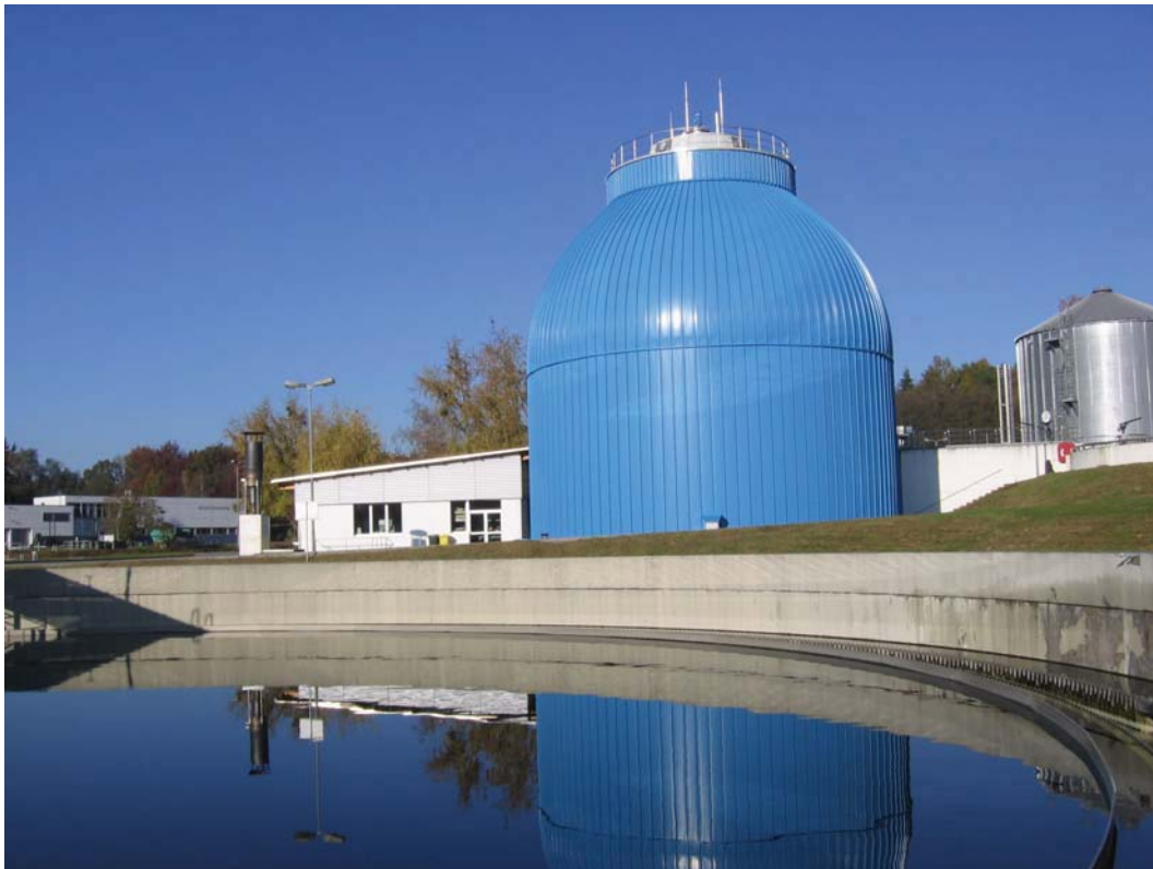
Faulturm und Nachklärbecken im Klärwerk
